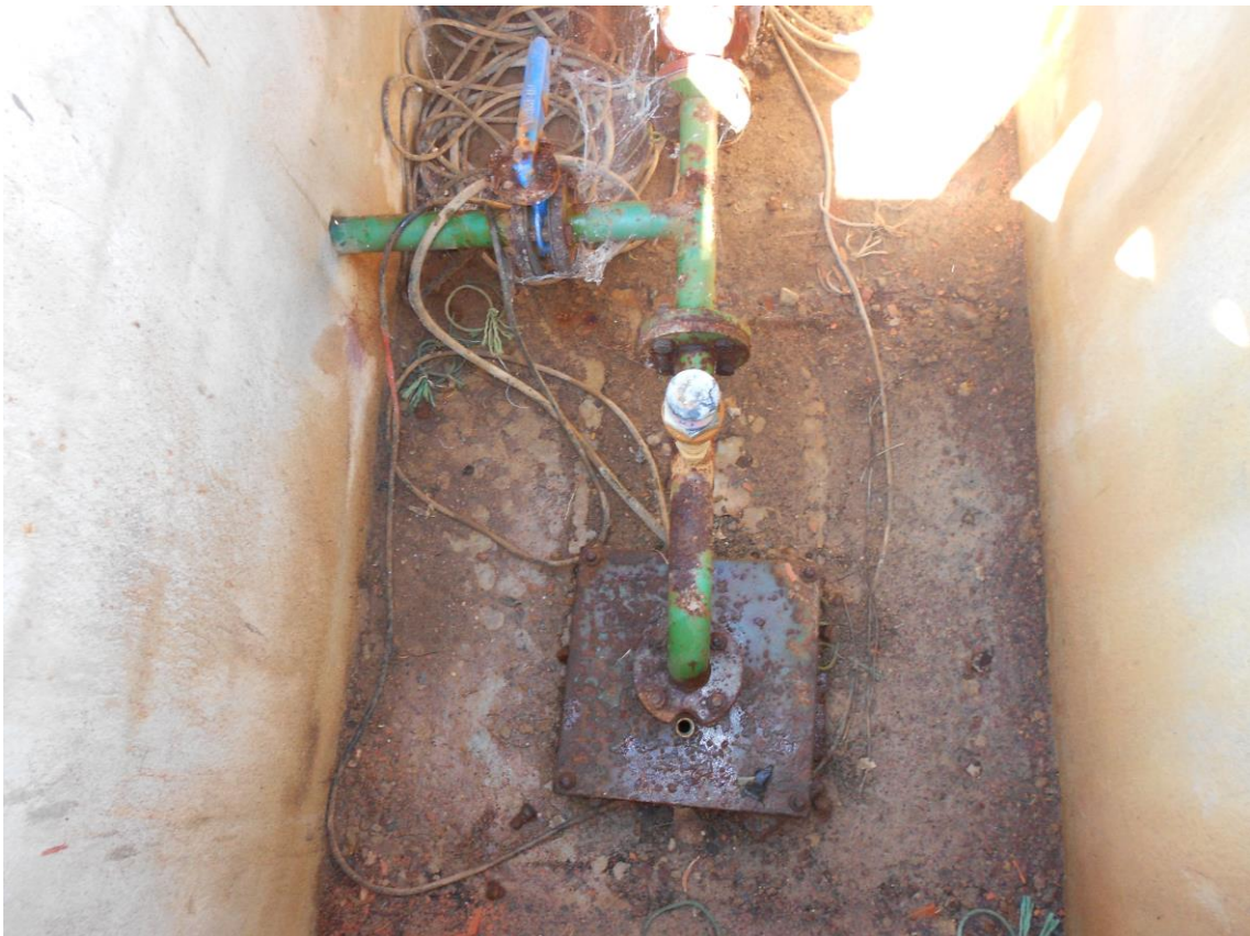
FOTO Nº 2: Detalle de la boca y la instalación del sondeo Las Puentecillas
