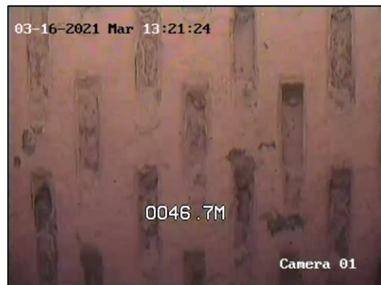
Figura 36. Tramo ranurado de tipo puentecillo.
