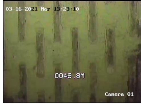
Figura 38. Tramo ranurado de tipo puentecillo.
