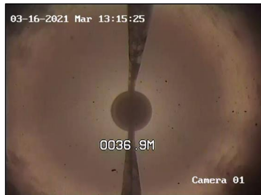
Figura 34. Tubería limpia y con apenas óxidos.
