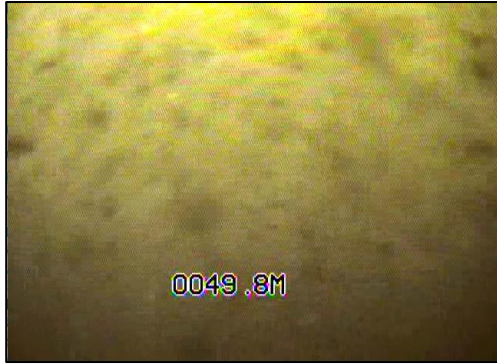
Figura 37. Tramo ranurado que no se observa por los óxidos.
