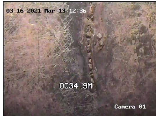
Figura 32. Tramo ranurado echas mediante soplete.
