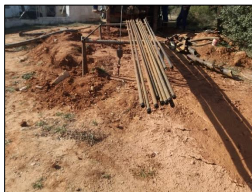
Figura 14. Tubería de inyección.
