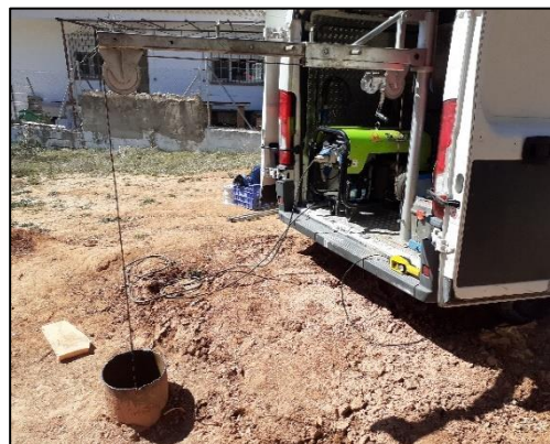
Figura 22. Emplazamiento de la URS de AQUATEC.
