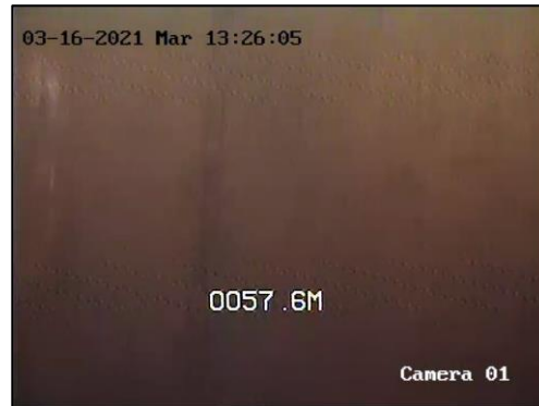
Figura 42. Tramo ranurado, cuyas ranuras no se observan correctamente debido a la turbidez.
