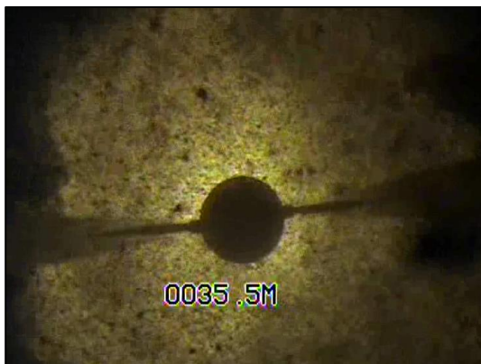
Figura 33. Tubería completamente tapizada de óxidos.
