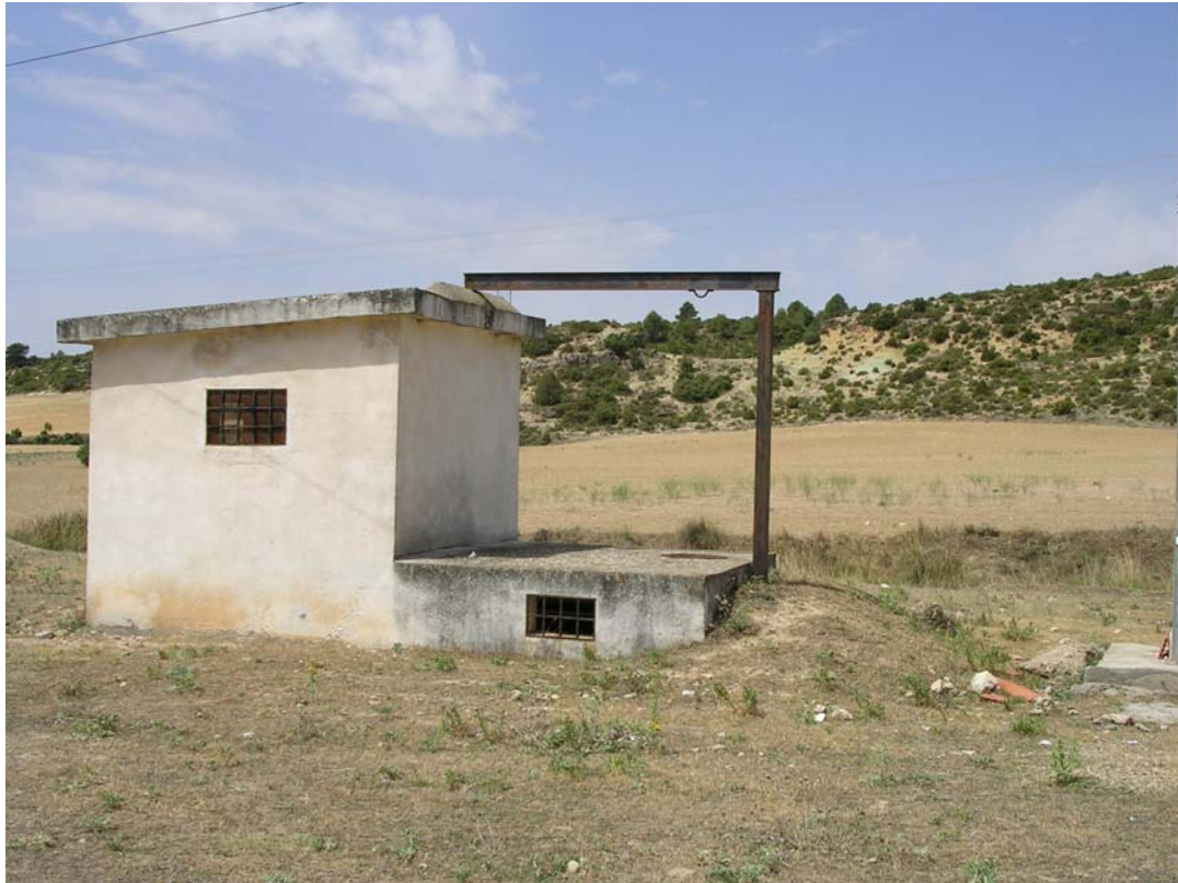
Foto 2- Captación Sondeo Valle.
