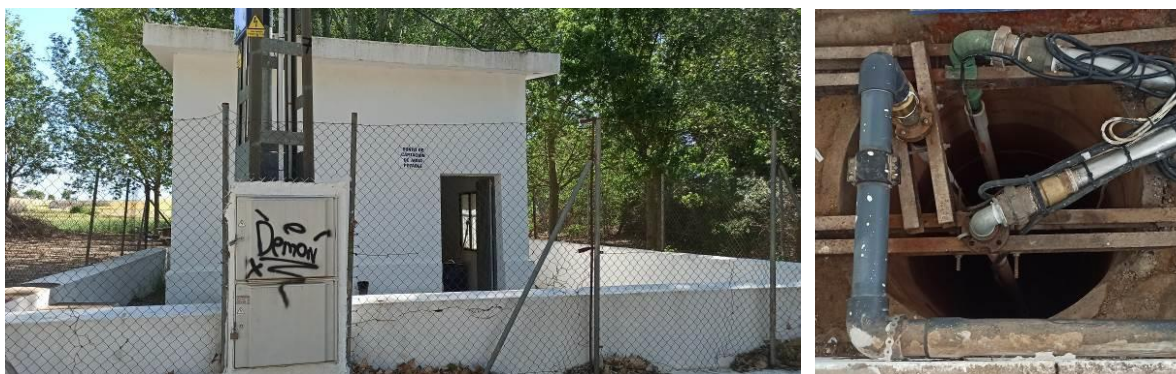
Figura 2. Pozo de abastecimiento a Cañada Juncosa
