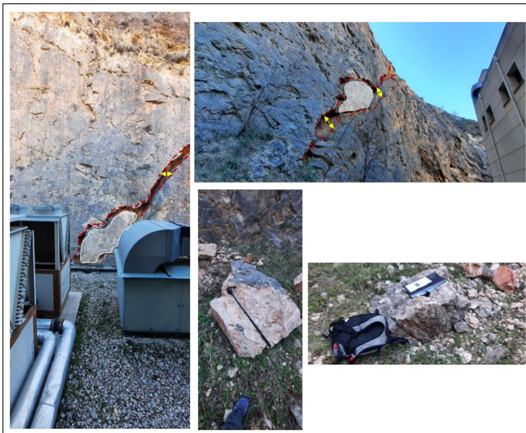
Fig.15. Fotografías tomadas desde distintos puntos de vista ilustrando el estado en el que se encuentra el bloque rocoso que se está separando del macizo por efecto de la acción erosiva del agua en la roca. La fotografía de la izquierda se ha tomado desde la cubierta del edificio mientras que la superior está realizada a cota de pie de talud. Las flechas marcan la separación de la grieta (1.5 m). Abajo, los bloques fragmentados con unos tamaños aproximados de 50*60 cm. En ellos se observan 2 tonalidades: la zona de color anaranjado corresponde a un corte fresco de la roca mientras que la parte negra, es la superficie alterada de la cara del talud.
