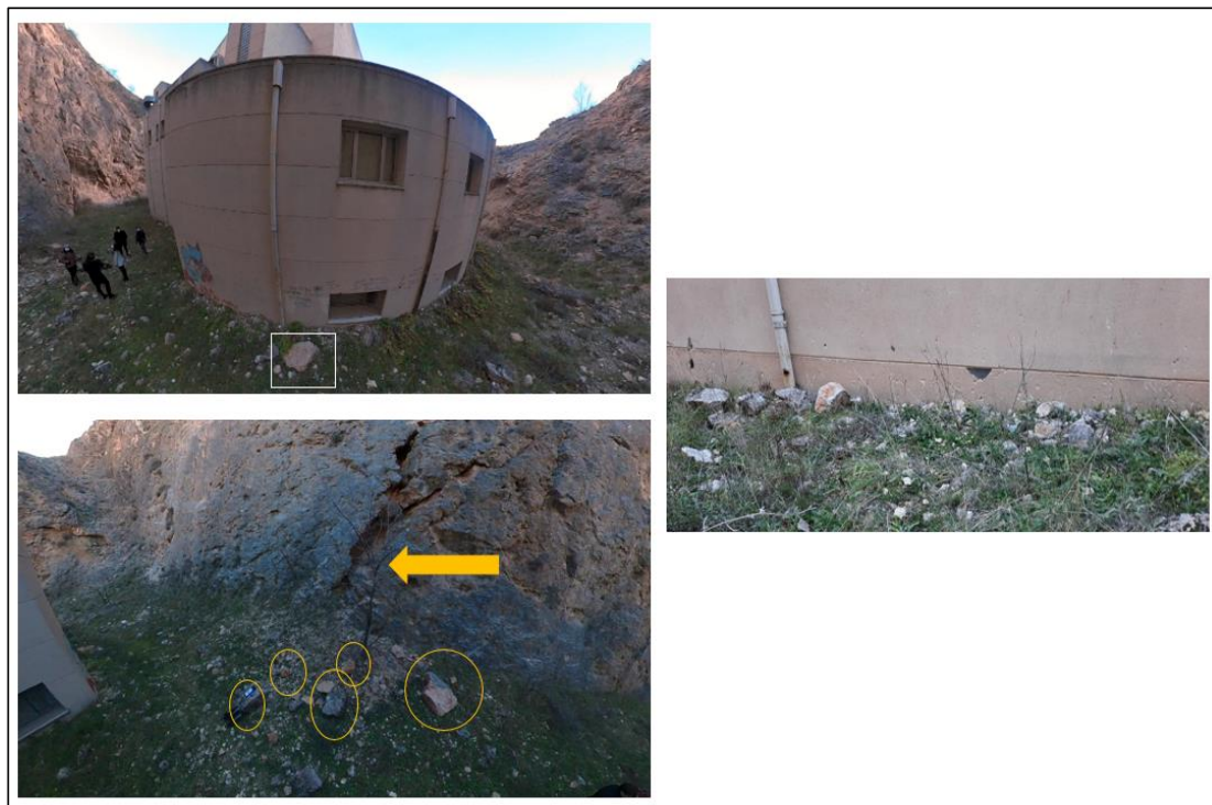
Fig.12. Localización de bloques de roca de distinto tamaño en toda la zona circundante al edificio. Son innumerables los bloques pequeños (centímetro/decímetro) aunque también, se aprecian fragmentos de tamaño métrico (cuadrado blanco). En la fotografía inferior los bloques rodeados con círculo proceden de la fragmentación de la última caída ocurrida en octubre de 2021 que proceden de la banda de disolución existente en el talud nº 2. El alcance de los bloques caídos llega hasta la misma fachada del edificio.
