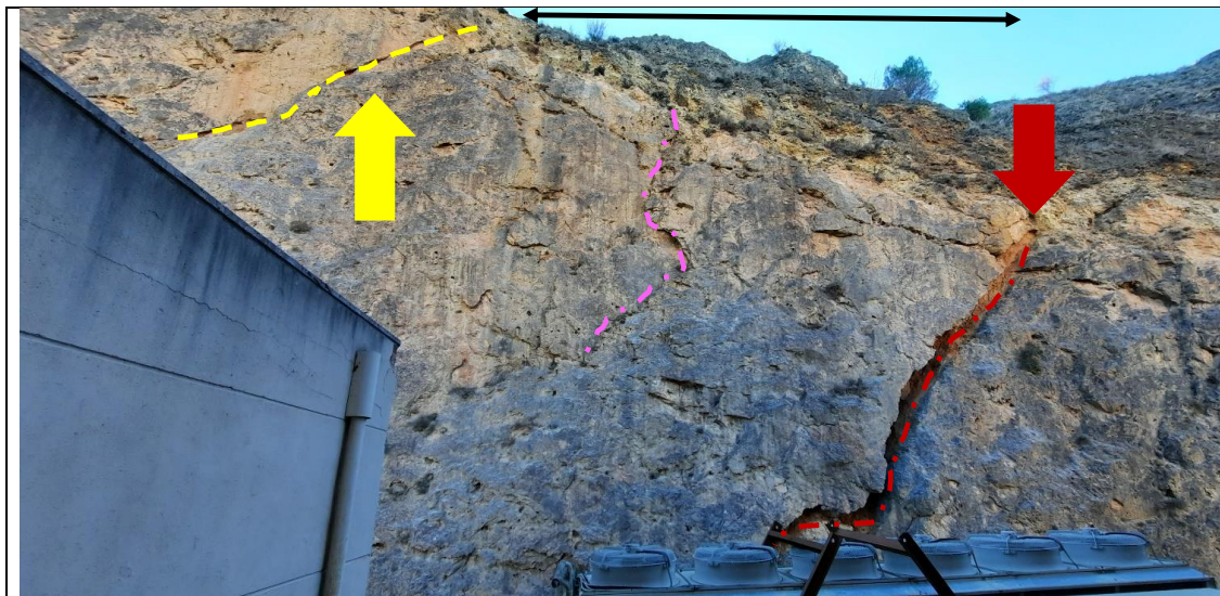
Fig.14. Fotografía tomada desde la cubierta del teatro auditorio en su parte trasera. Se observan 2 bandas oblicuas al talud vertical y otra incipiente a distinta cota topográfica. La banda con mayor apertura (1.5 m) de menor cota topográfica se ha representado con trazo marrón y tiene continuidad hacia la parte baja del talud mientras que la otra banda de menor anchura (< 0.5 m), se localiza a mayor cota topográfica y se ha representado con trazo amarillo.
