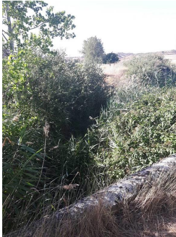
Foto 4. Punto de vertido del agua residual sin tratamiento.
