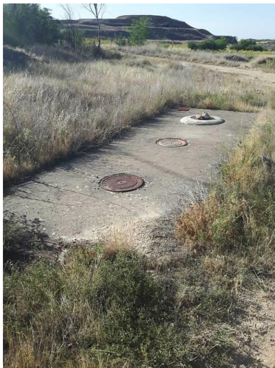
Foto 5. Colector situado en las inmediaciones del sondeo.
