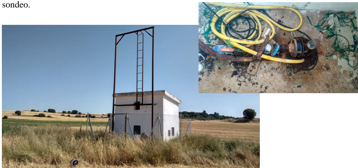
Figura 2. Sondeo de abastecimiento a Olmeda del Rey
