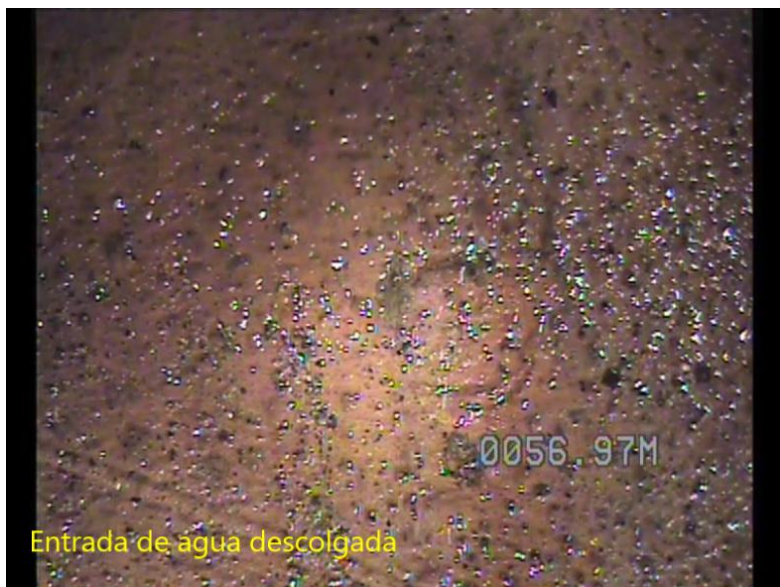
Entrada de agua descolgada por ranura, 56,97 m
