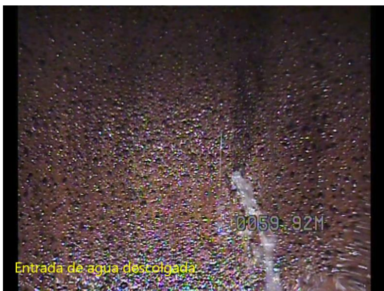
Entrada de agua descolgada por poro del entubado, 59,92 m
