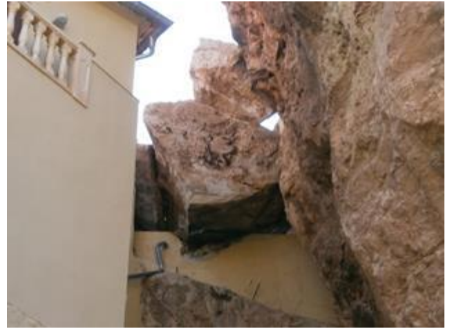
Detalle de los desprendimientos.
