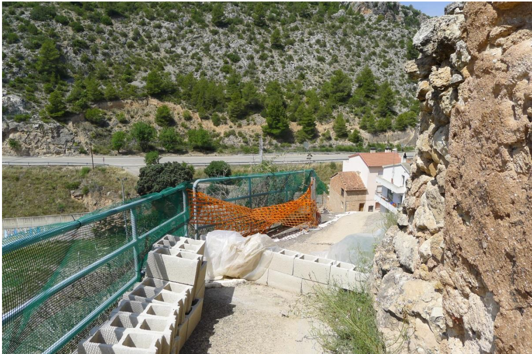
Figura 27. Cabecera de la ladera con problemas de deslizamiento. Se están realizando unas obras con la finalidad de reforzar esta zona y evitar la entrada de agua por las grietas.
