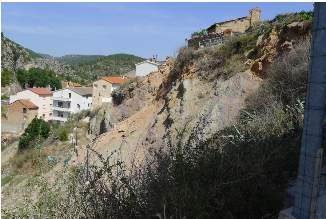
Figura 25. Ladera afectada por deslizamientos que han destruido un camino y causado daños y grietas en la zona de cabecera, afectando a la población.
