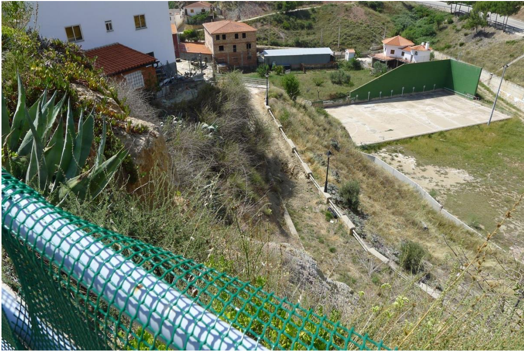
Figura 26. Vista de la ladera deslizada frente a la calle Subida Calvario.
