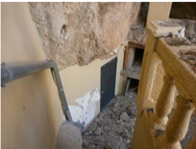
Restos de materiales en el patio interior.
