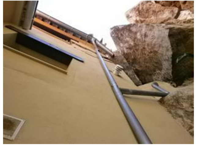
Fachada con desprendimientos en la parte superior.
