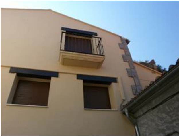
Fachada con grietas en la parte superior dcha.
