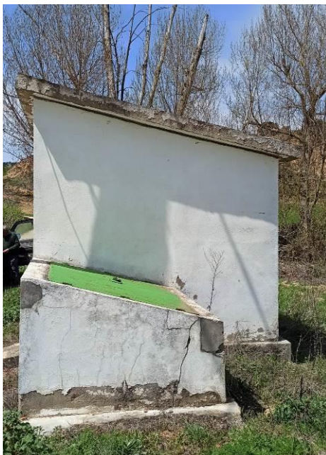
Figura 5. Sondeo antiguo de abastecimiento a Torrejuncillo del Rey, Naharros y Villar del Águila
