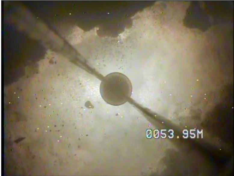
Incrustaciones y cascarillas, 53,95 m
