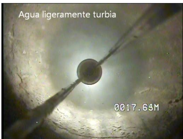
Agua ligeramente turbia, 17,64 m
