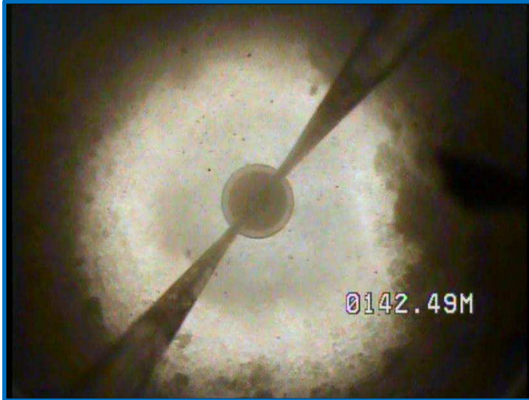
Vista general del sondeo a 142,49 m, aumentan las incrustaciones.
