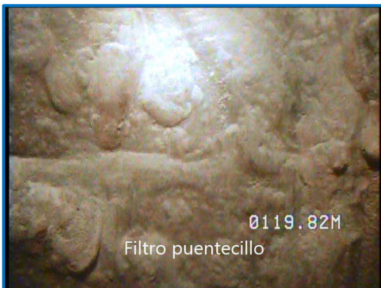
Comienza el filtro puentecillo 2 y se encuentra muy colmatado, 119,82 m
