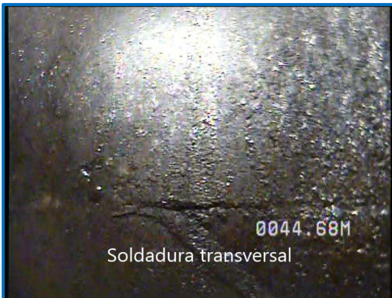
Detalle de una soldadura transversal, 44,68 m
