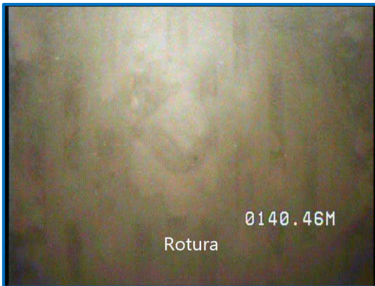
Rotura en filtro puentecillo, se aprecia una piedra tapando el orificio, 140, 46 m
