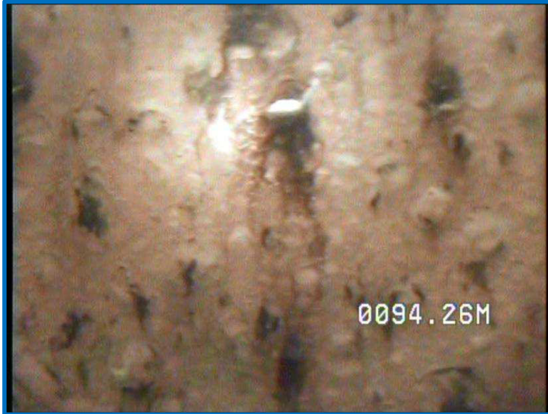
Detalle de pared de entubación, incrustaciones, 94,26 m
