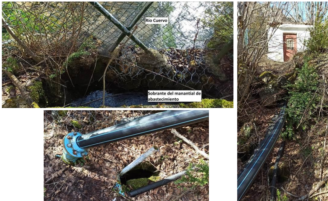
Figura 2. Captación del manantial de abastecimiento de Vega del Codorno
