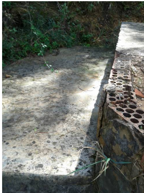
Figura 3. Deficiencias en el estado de conservación del depósito. Existencia de grietas
