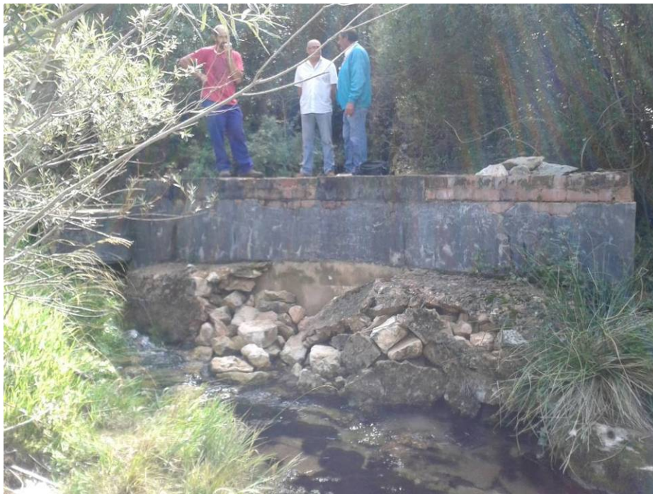
Figura 1. Manantial de abastecimiento a Villalba de la Sierra y depósito
