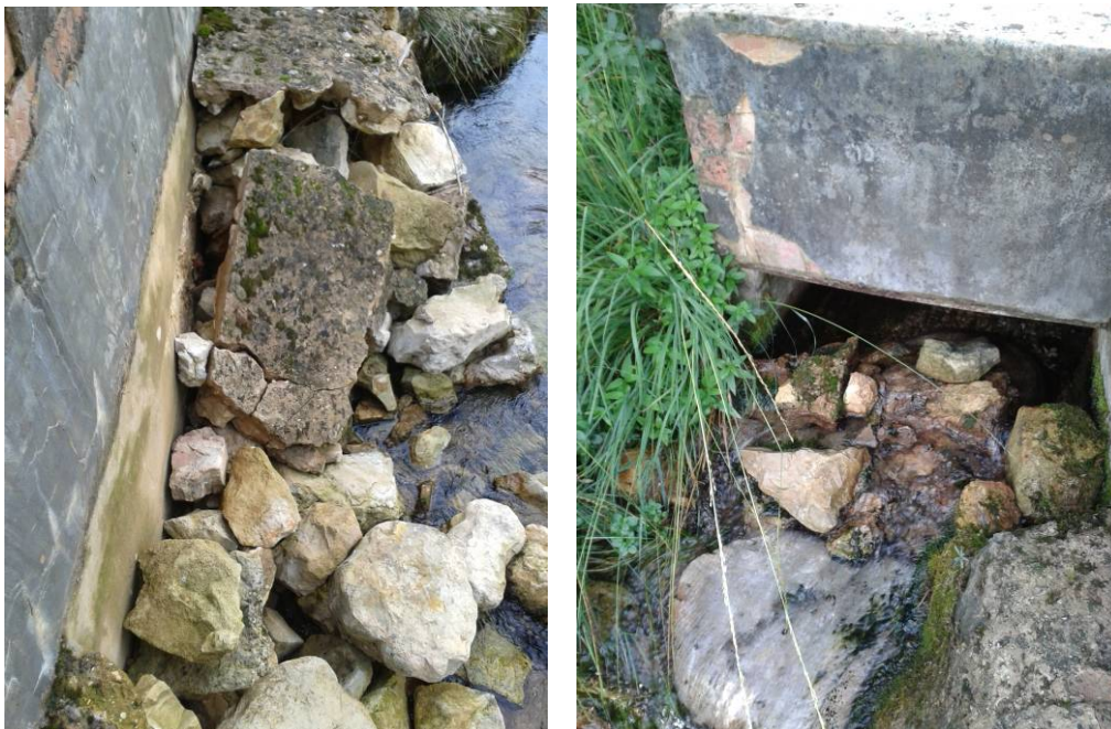
Figura 2. Patología 1: Pérdidas importantes al pie del muro del depósito (izquierda).
