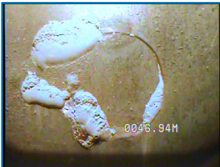
Posibles signos de entrada de arena por orejetas, 46,94 m
