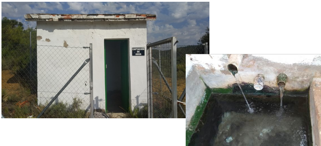
Figura 4. Caseta de captación de los caudales de los tres manantiales de Fuente Zarza
