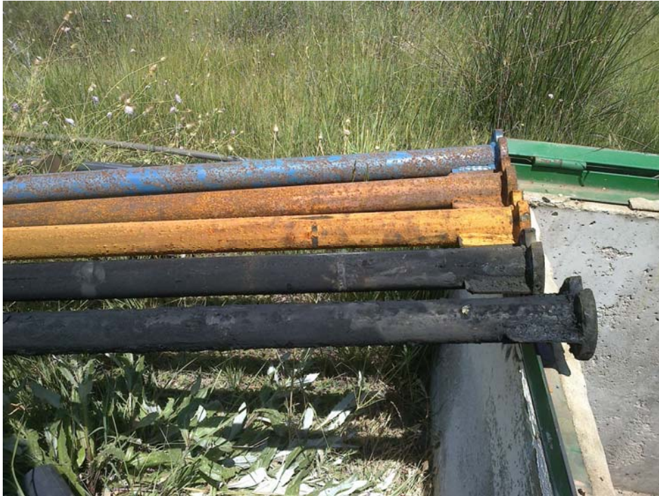
Figura 3. Detalle de las tuberías auxiliares.
